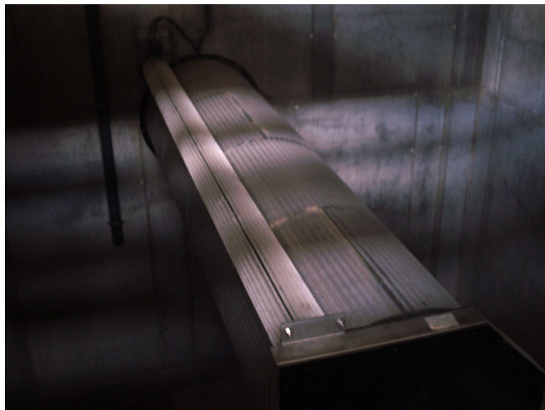
ROTOR DN1.000, LONGITUD 4mts CON CAPACIDAD DE 1.816 l/s (Lugo).
