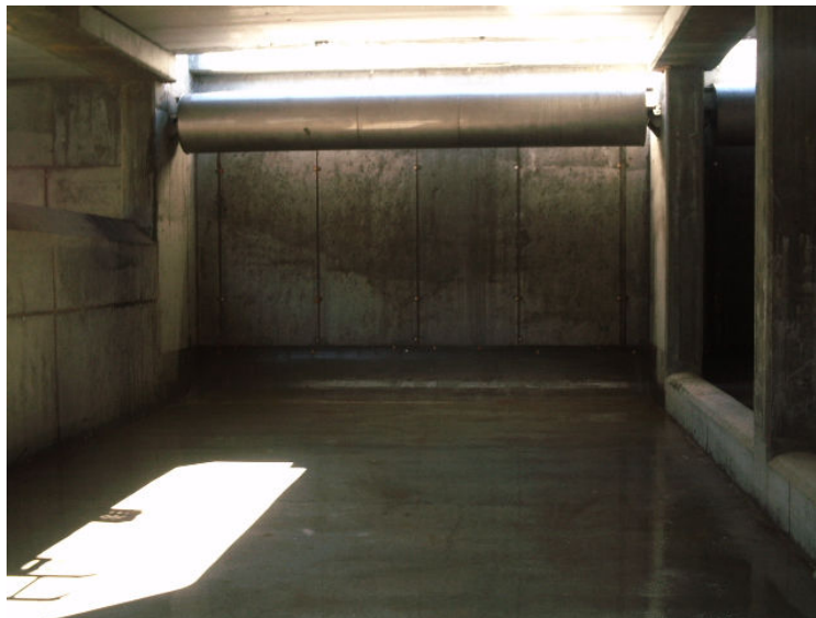
LIMPIADOR AUTO-BASCULANTE V=400 l/m DE 6 METROS DE LONGITUD. COLOCADO A 5 METROS DE ALTURA (LUGO)
