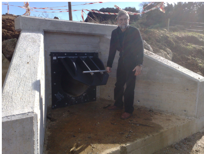
CLAPETA CIRCULAR CWi_R-O DN600 INSTALADA EN OREJETA DE HORMIGÓN (Cantabria).
